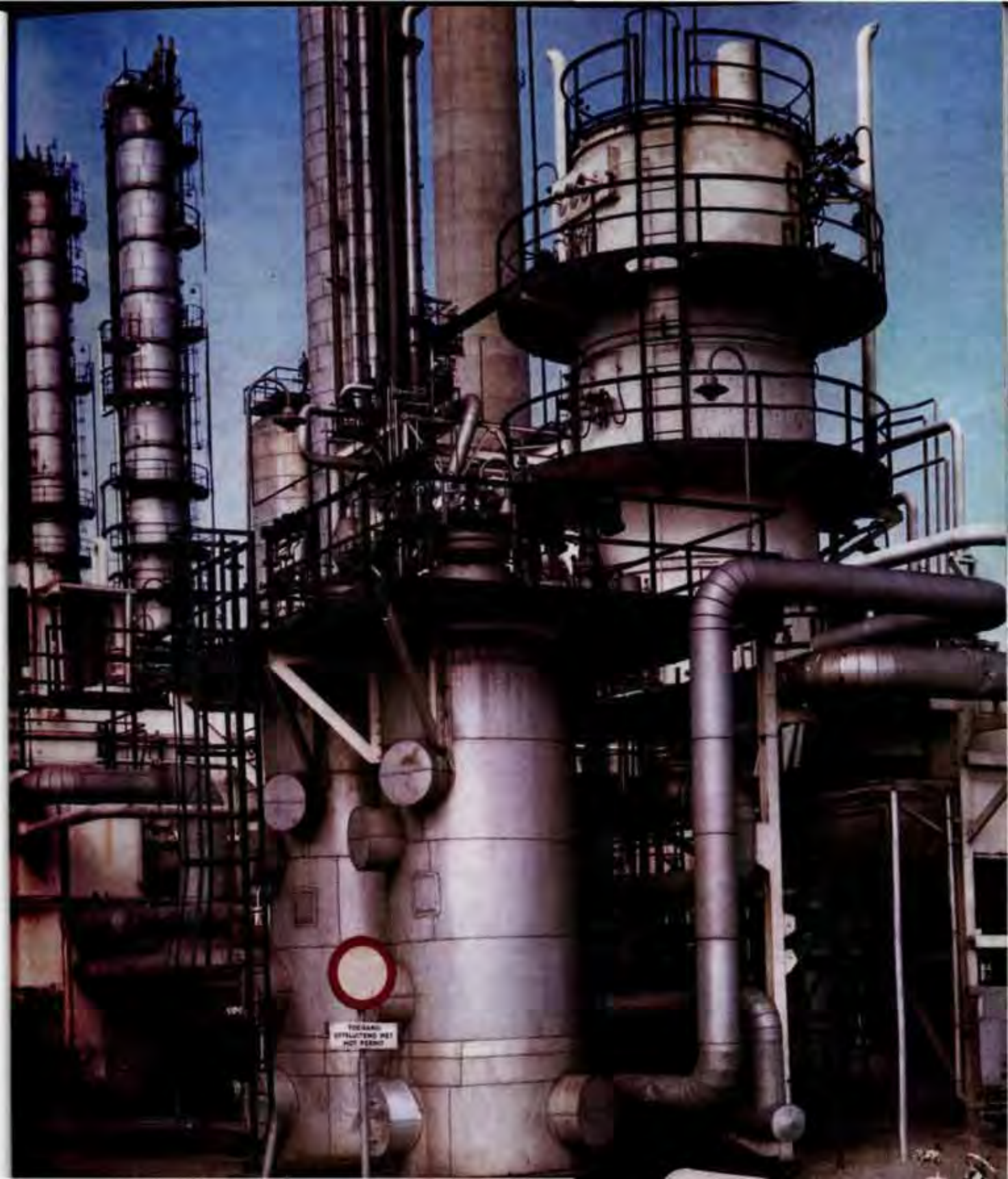
Tieftemperaturanlage zur Wasserstoffkonzentrierung in einer Raffinerie
