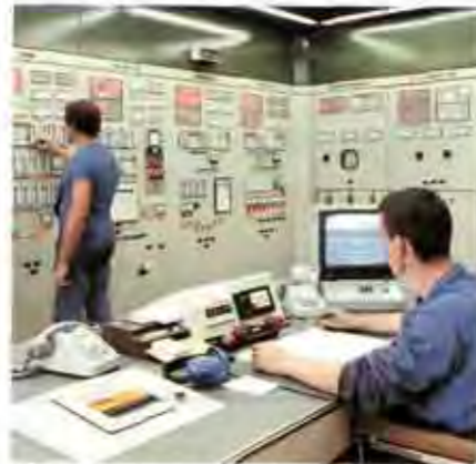
Die Luftzerlegung in der Produktionsanlage der Airgaz in Frankreich wird zentral gesteuert
