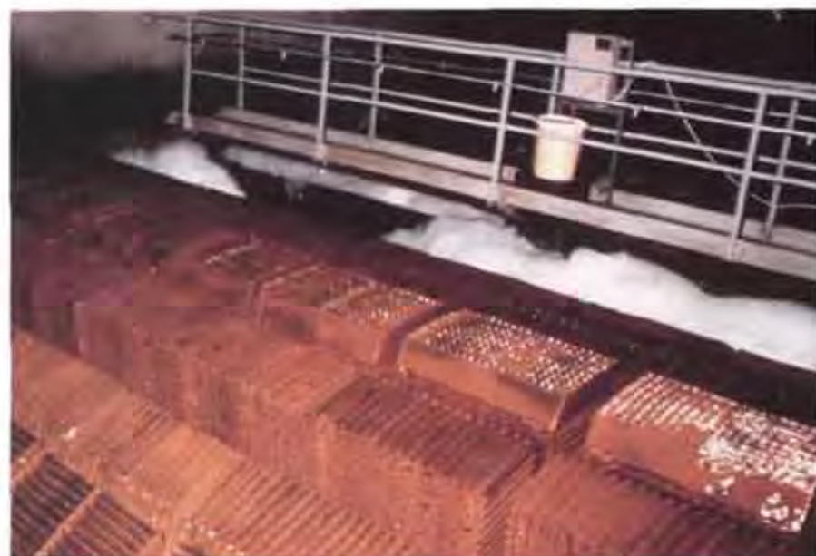
Vier Fußballfelder groß ist die unterirdisch in ihrer Fels gehauene Kläranlage am Oslo-Fjord. Der Sauerstoff wird über poröse Schläuche ins Wasser eingetragen, das durch einen 750 Meter langen Tunnel passiert ins Meer fließt.
