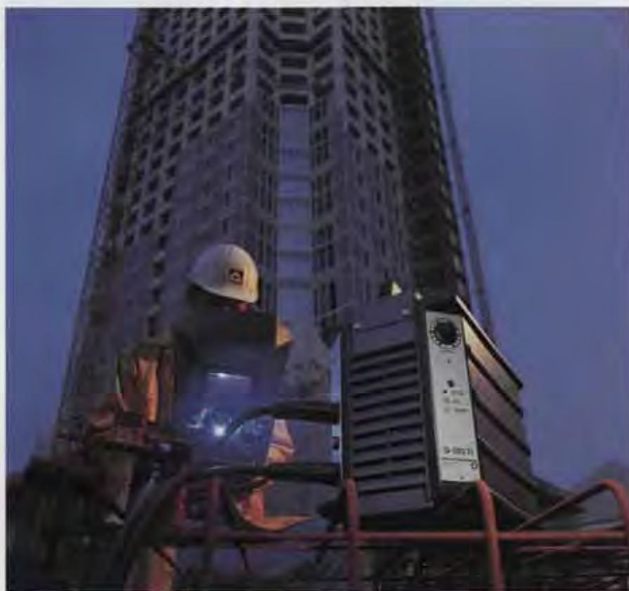
Mit 256 Metern Höhe wird der Frankfurter Messeturm das höchste Gebäude Europas sein. Ein Gleichrichter aus unserer neuen Baureihe hat den Härte-test auf der Baustelle bestanden; er wiegt mit 25 Kilogramm nur ein Neuntel eines konventionellen Schweißgeräts und erleichtert den Transport.
