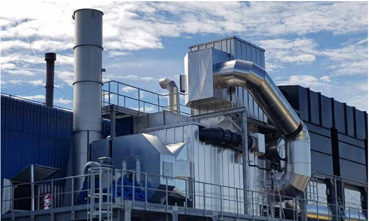
Regenerative thermische Nachverbrennung zur Reinigung von lösungsmittelhaltigen Abgasen mit integrierter Wärmerückgewinnung für Heißluft und Dampf.
