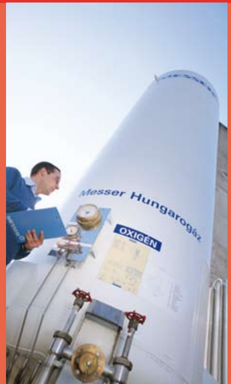
Der flüssige Sauerstoff wird in Tanks direkt auf dem Gelände des Kunden gelagert.
