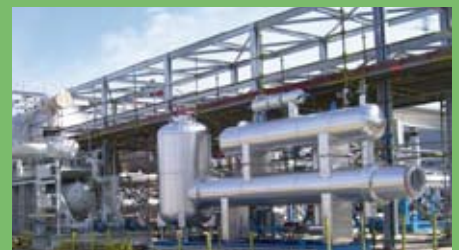
Transparente Technik: CO 2 -Verflüssigungsanlage
